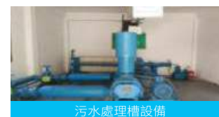
污水處理槽設備
