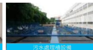
污水處理槽設備
