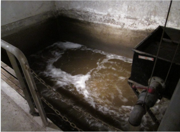
汙水處理槽設備
