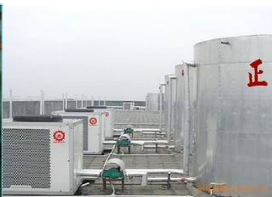
圖：三聯供熱泵機組
