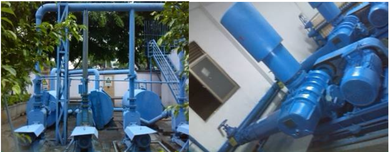
圖：生活污水處理站設備
